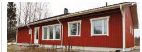
Ennen 2000-lukua asennetuissa salaojissa on usein puutteita, sillä salaojituksen määräykset tiukentuivat vuosituhaten vaihteessa.
